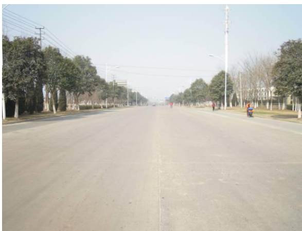
图 2.2-1 (b) S242 段路面现状
