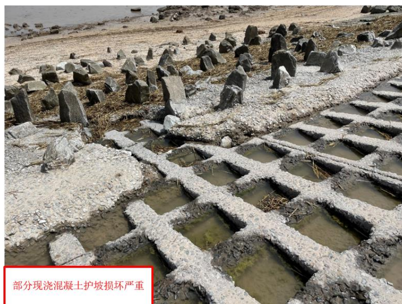
图 35 桩号 133+496~133+865 段现状护坡损毁图
