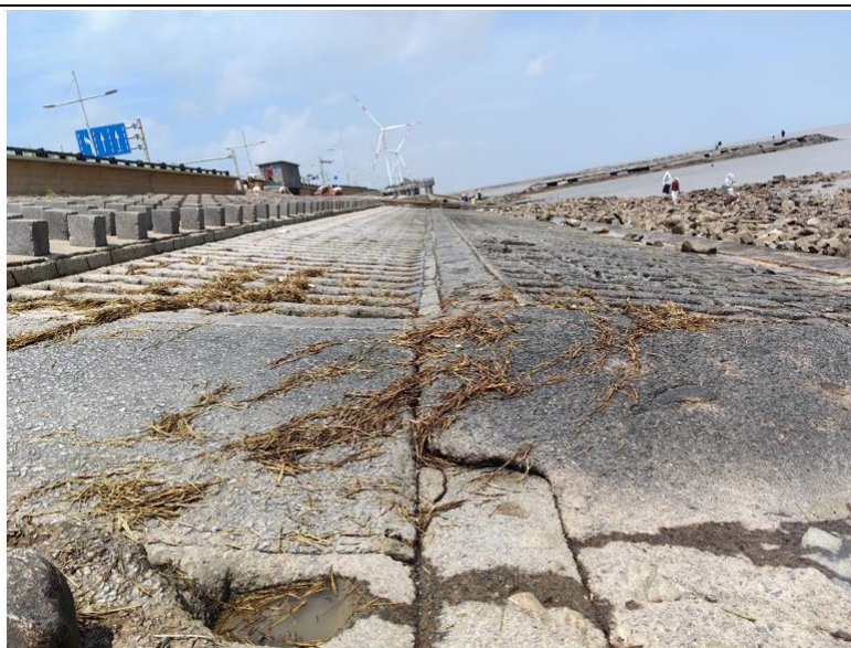
图 31 桩号 133+404~133+496 段现状护坡损毁图
