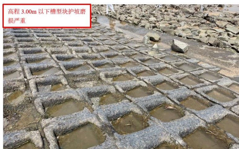
图 32 桩号 133+404~133+496 段现状护坡损毁图
