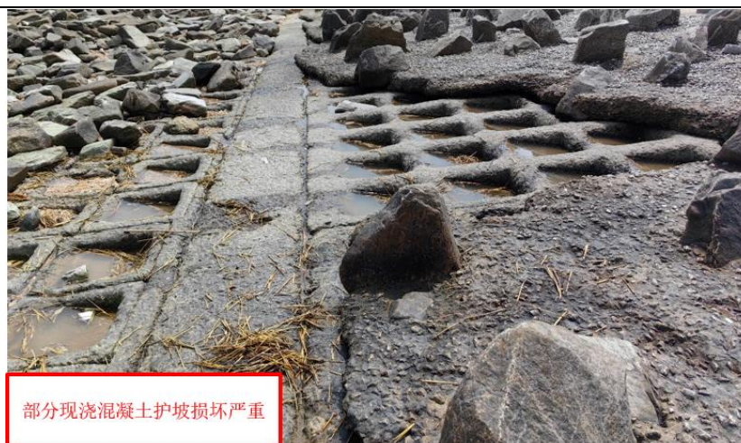
图 34 桩号 133+496~133+865 段现状护坡损毁图
