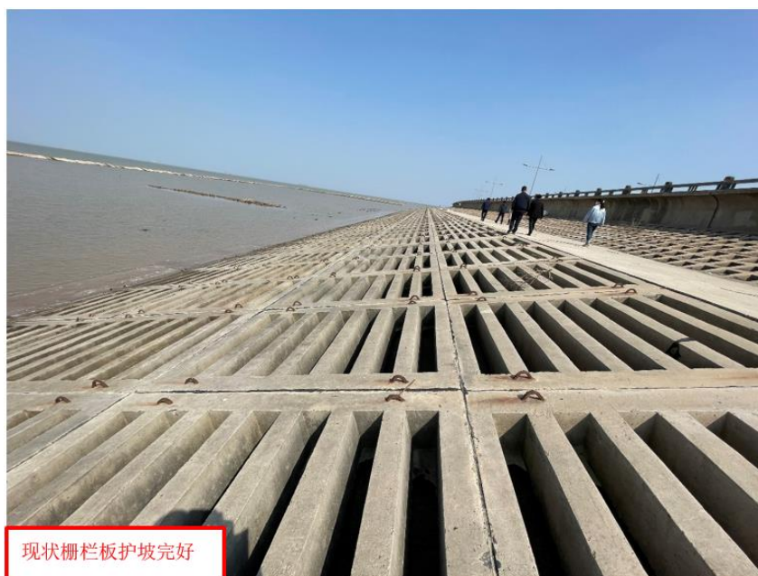
图 37 栅栏板护坡现状图片
