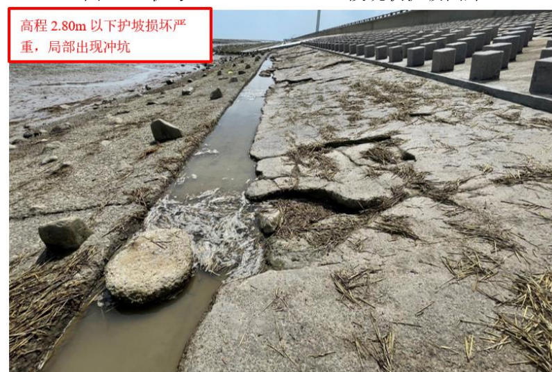
图 28 桩号 132+112~132+342 段现状护坡损毁图
