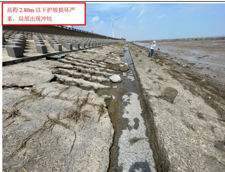
图 29 桩号 132+112~132+342 段现状护坡损毁图
