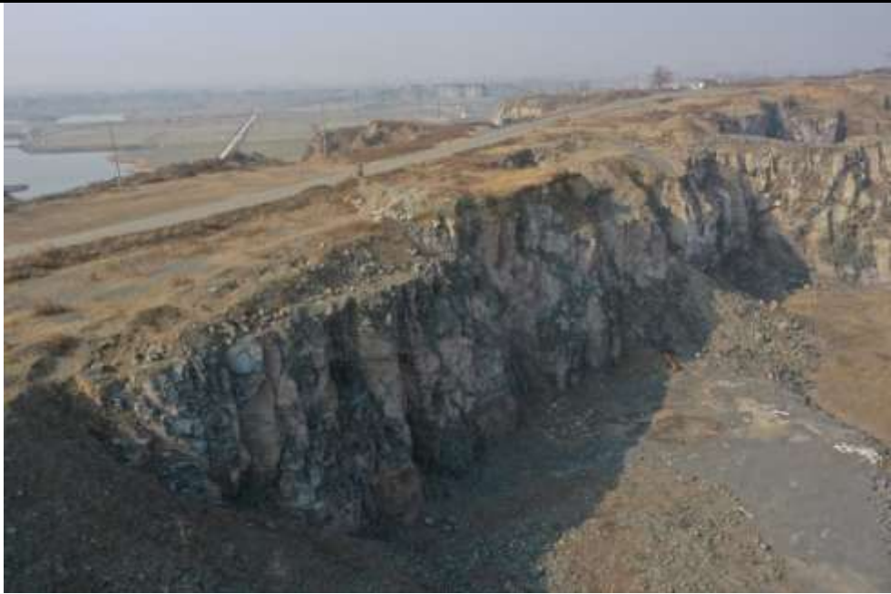
图 3-21 项目区中部路肩的高陡边坡
