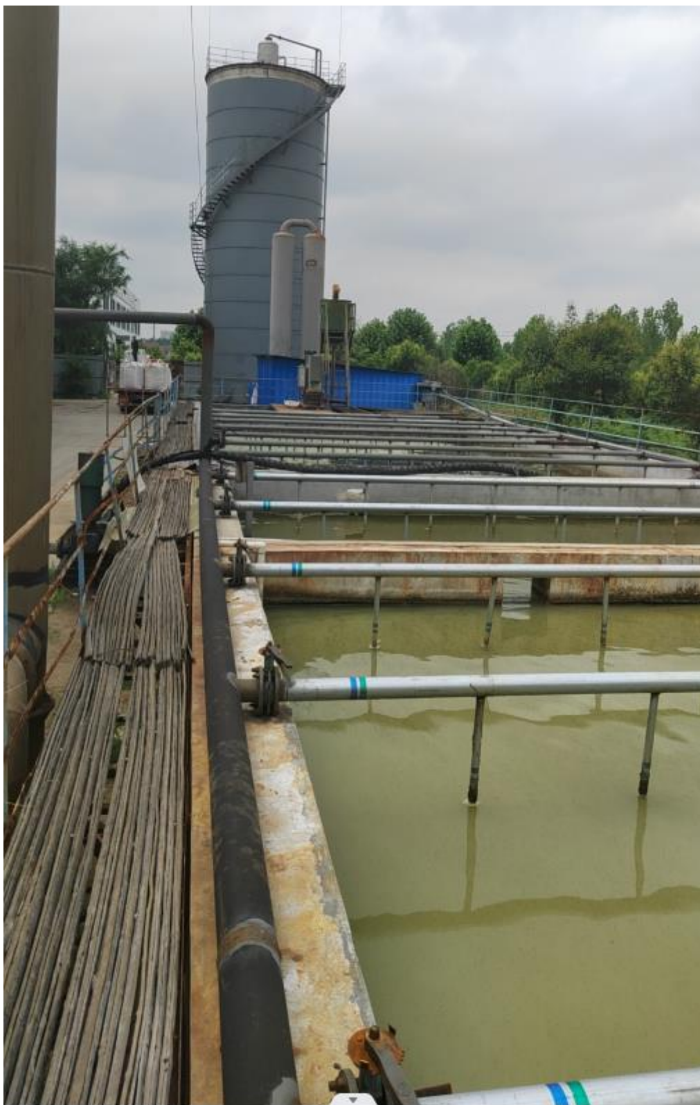
润美公司废水站现场
