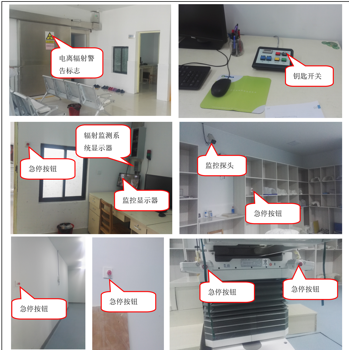
图 10-2 加速器机房辐射安全措施现状图
